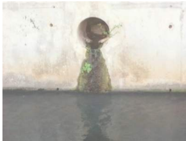
Figura 5: Tubería que vierte residuos al canal
