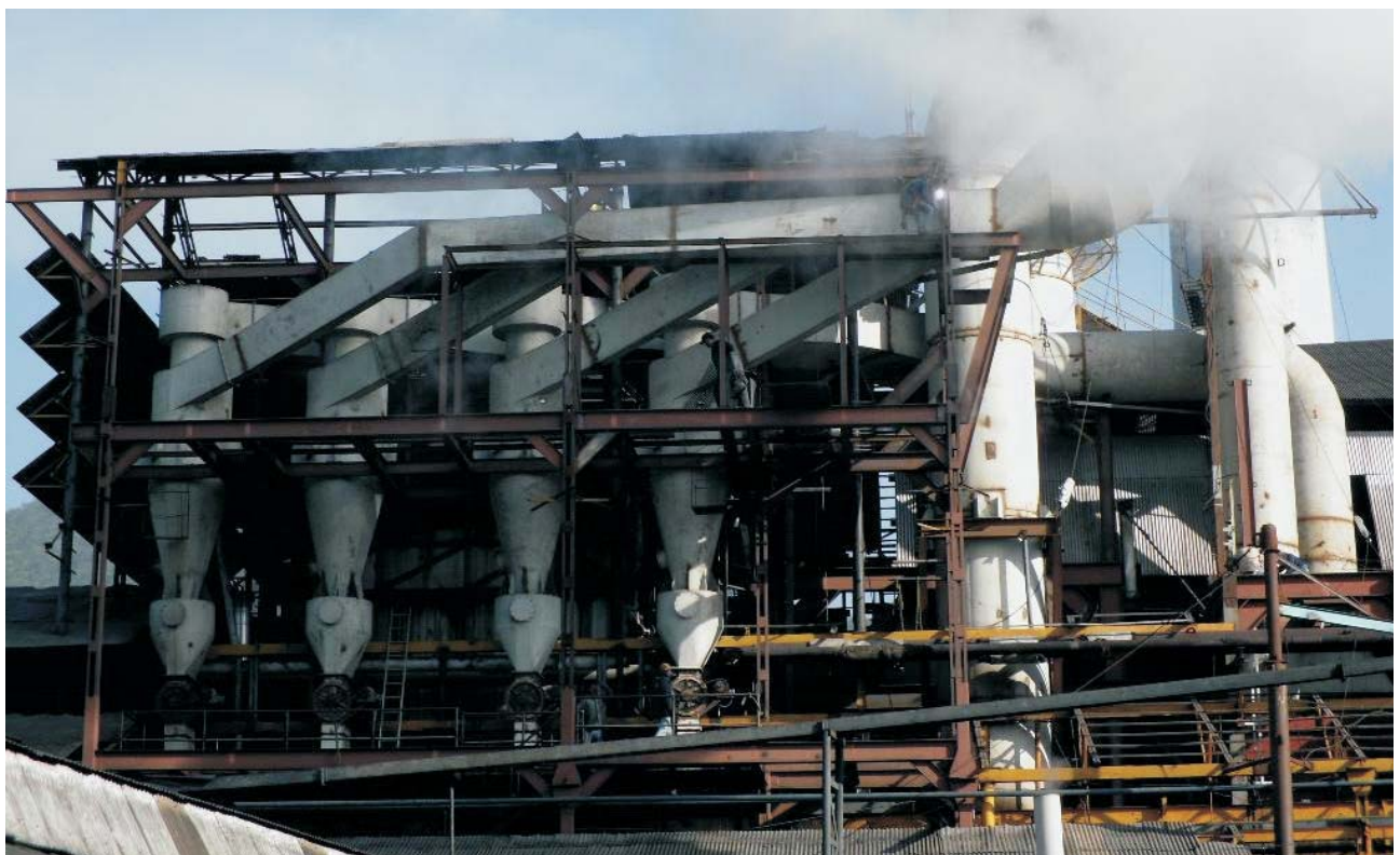
Figura 2. Vista frontal del secador en operación. Ingenio El Carmen, México, 2010.
